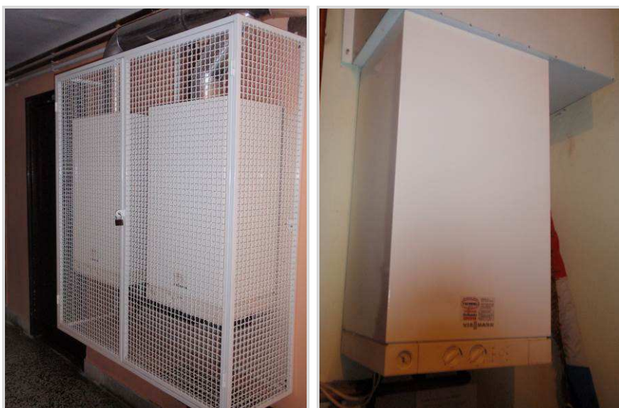
Slika 40: Kombi bojleri na III. katu Glazbene škole
