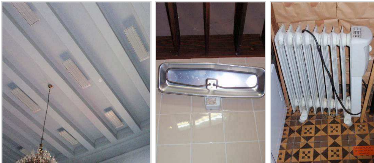
Slika 65: Toplinski uređaji u zgradi
