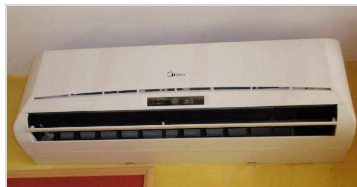
Slika 49: Unutarnje jedinice split rashladnih uređaja
