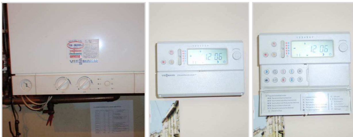
Slika 41: Upravljački uređaji grijanja u Glazbenoj školi
