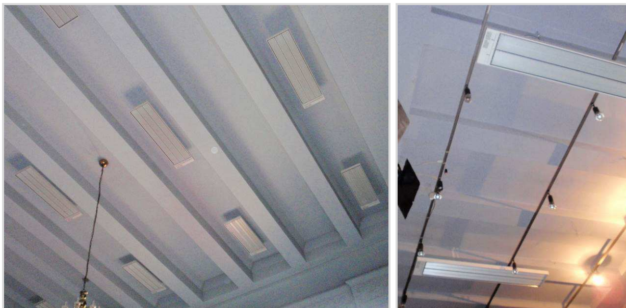
Slika 37: Stropne električne infra grijalice u Velikoj dvorani
