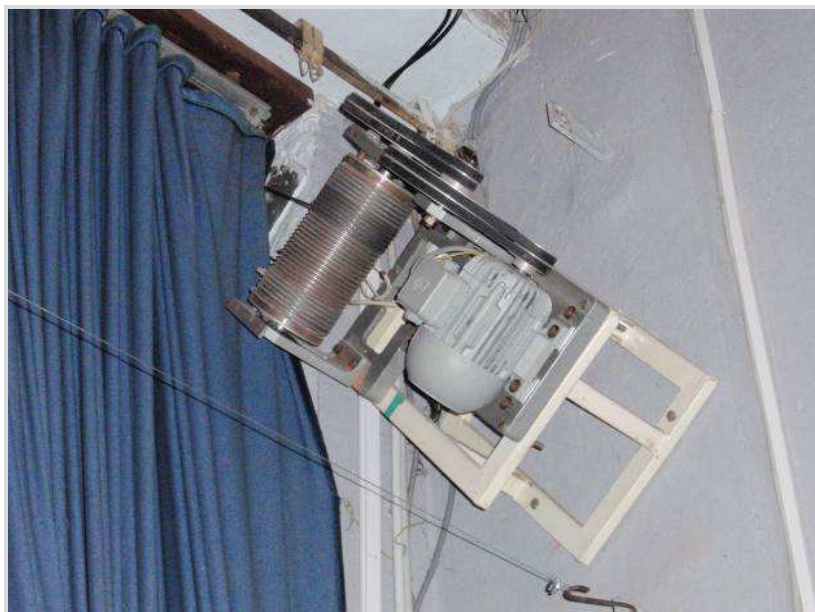
Slika 66: Elektromotor za podizanje/spuštanje zavjese pozornice
