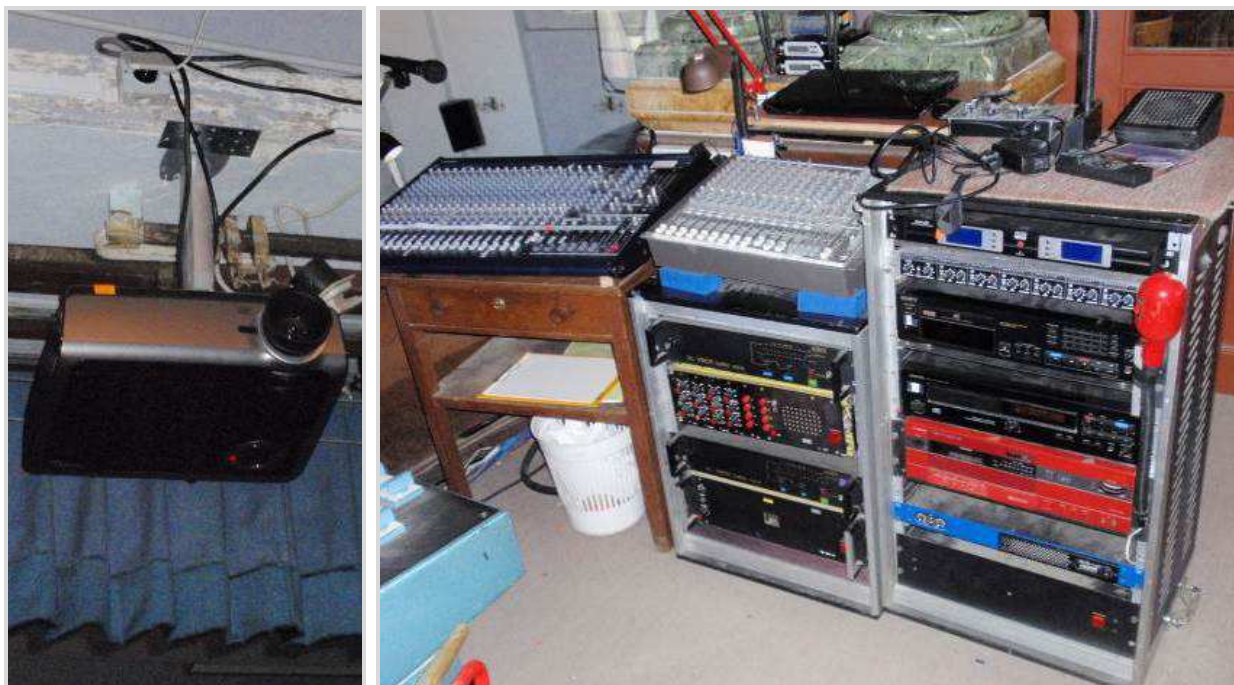
Slika 61: Električna oprema u Velikoj dvorani
