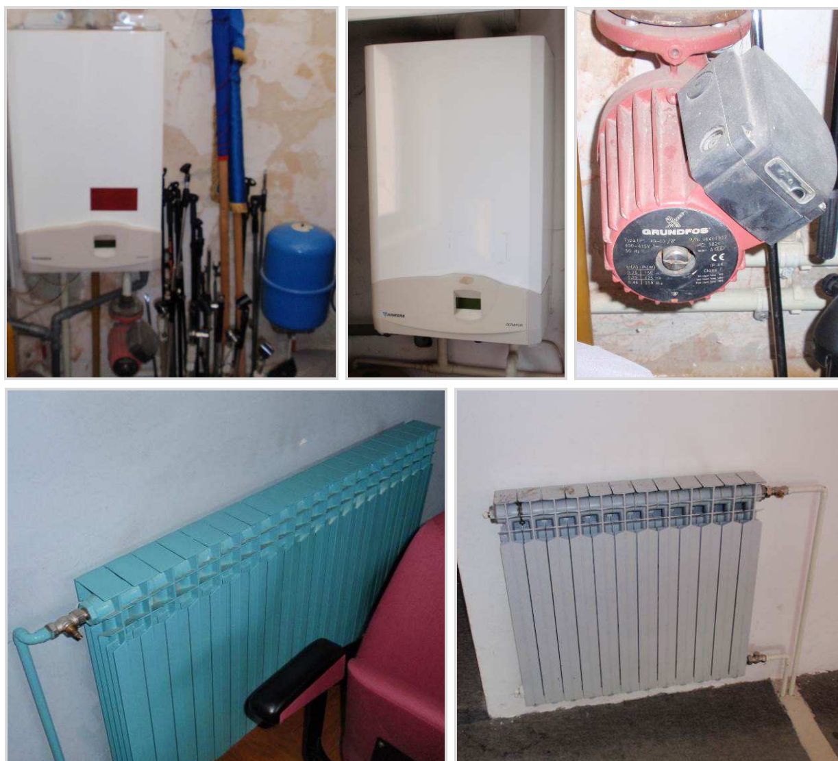
Slika 35: Dijelovi sustava grijanja Velike dvorane
